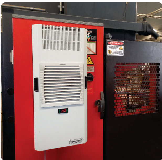
Aire acondicionado | Enfriador TASCO aplicado al tablero
